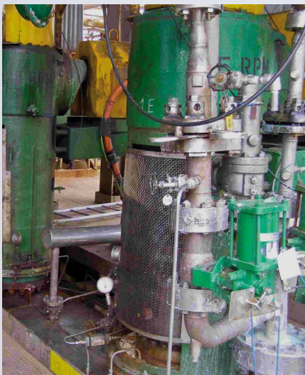
Autoklaven in der Kwinana Nickelraffinerie
